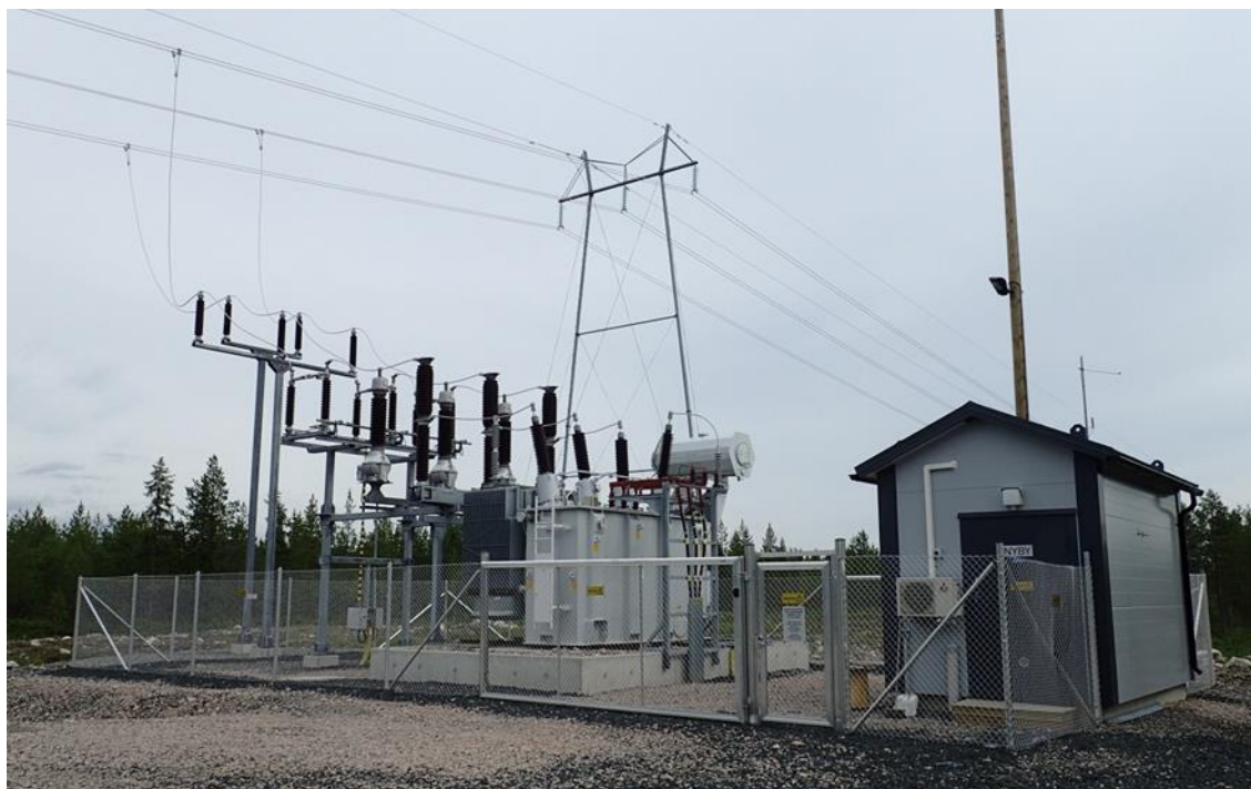
Kuva 77. Esimerkki tuulivoimapuiston sähköasemasta (kuva Minna Takalo/FCG).
