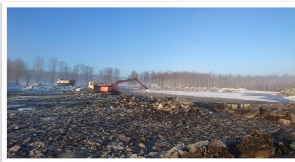
KUVA 10. Parkkimanjoen laskeutusaltaan tyhjennystä. Altaasta poistettiin lietettä noin .000 m 3 . Lisäksi altaaseen rakennettiin huoltoteitä liki 100 m. Huoltotiet jäävät vesirajan alapuolelle altaan ollessa toiminnassa.
