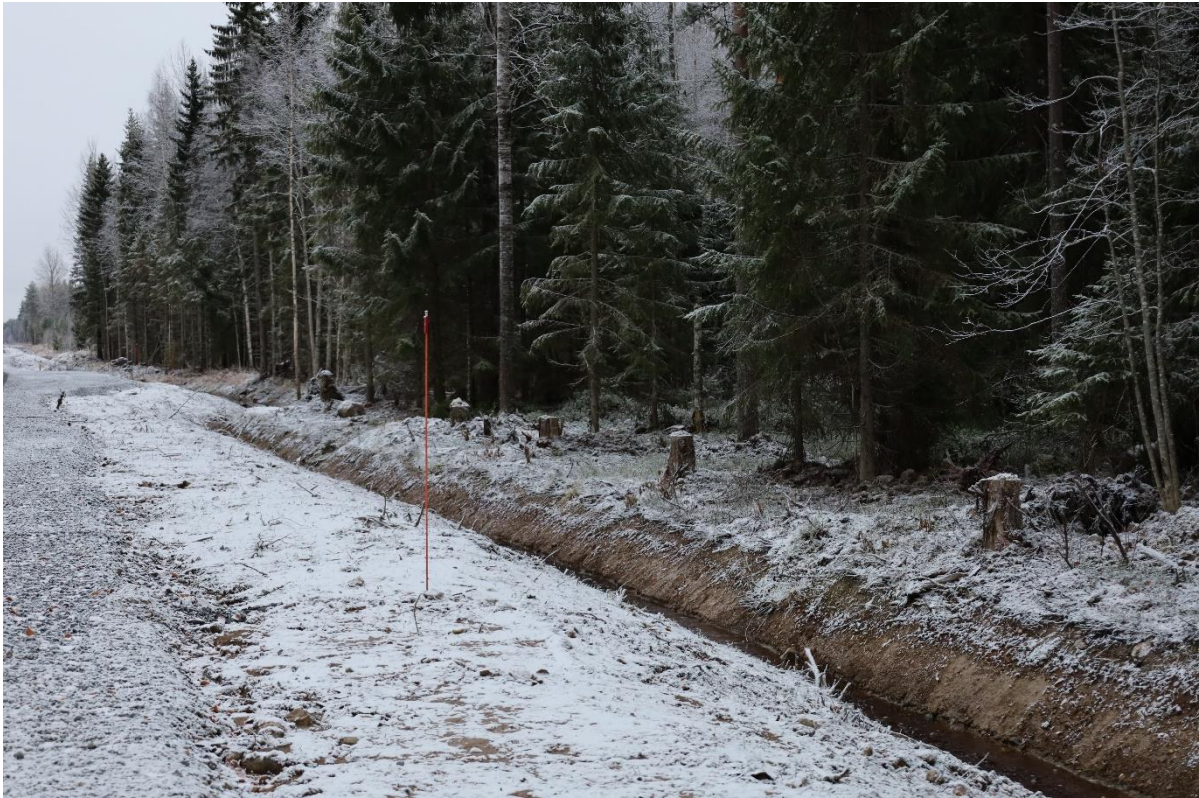
Kuva 26-21. Murtomäen tuulivoimahankkeen huoltotien viereen sijoitettu maakaapeli merkitään ja maakaapelireitiltä puusto raivataan jatkossakin, jottei puiden juuri pääse voittamaan maahan kaivettua kaapelia.
