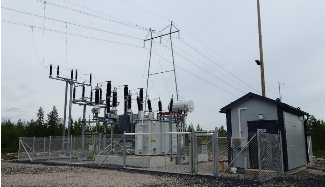
Kuva 2-14 Esimerkki tuulivoimapuiston sähköasemasta.
