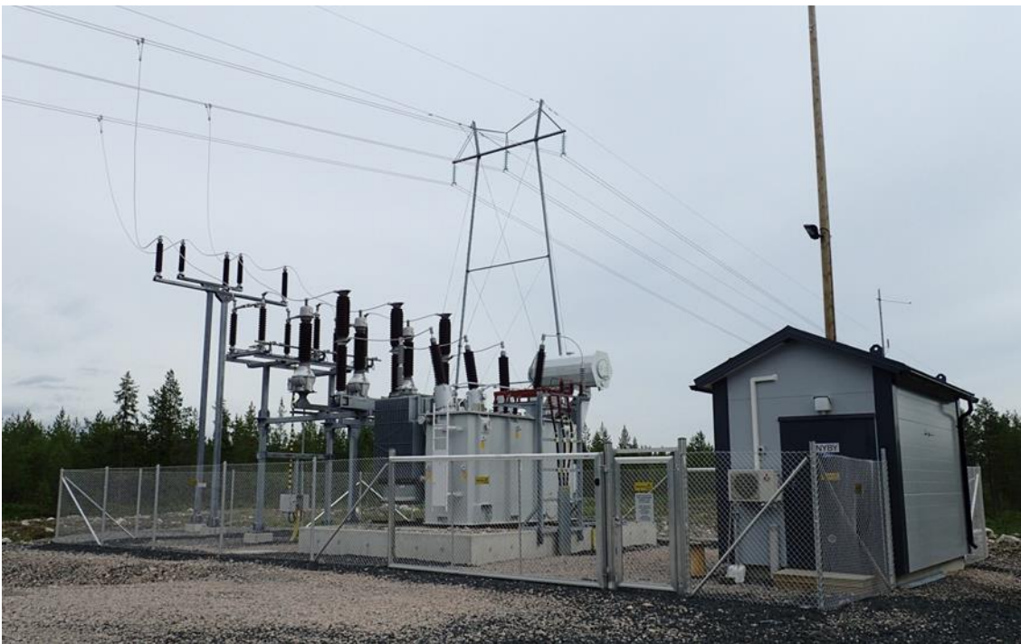
Kuva 77. Esimerkki tuulivoimapuiston sähköasemasta (kuva Minna Takalo/FCG).
