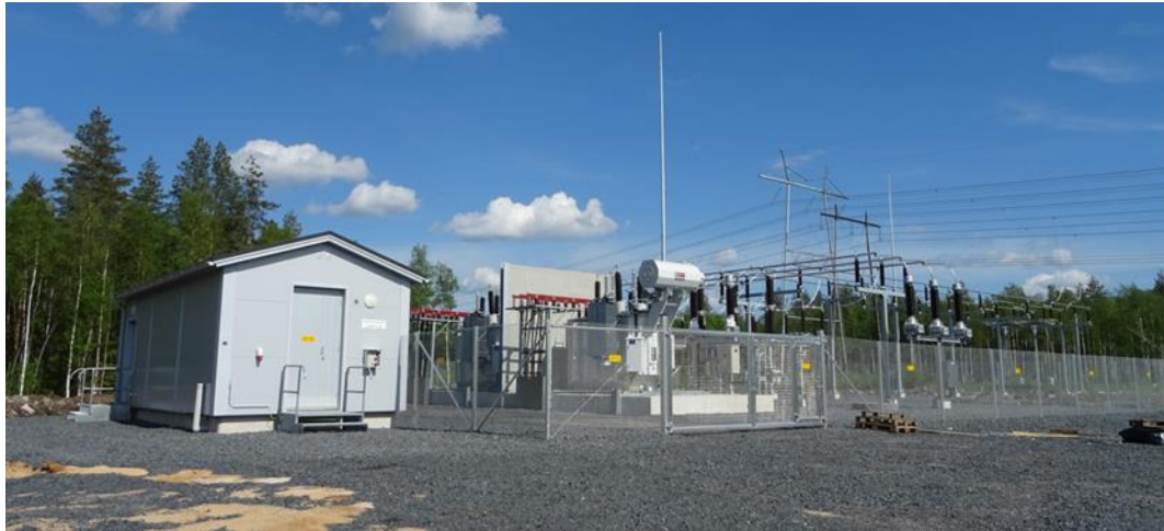
Kuva 14. Esimerkki tuulivoimapuiston sähköasemasta (Oltava, Pyhäjoki).
